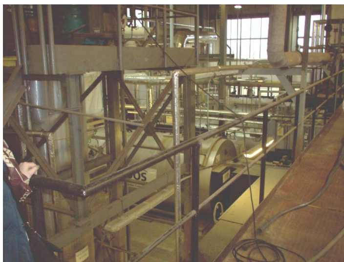
Obr. 4: Kotle na zemní plyn
